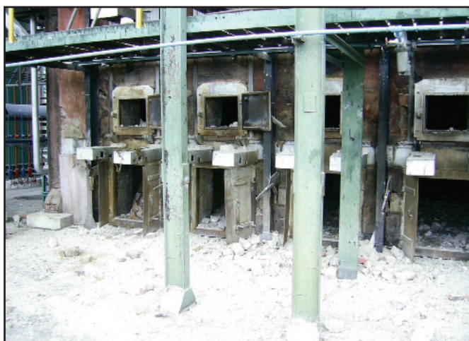
Fornalha da caldeira abandonada: realidade atual do setor sucroenergético
